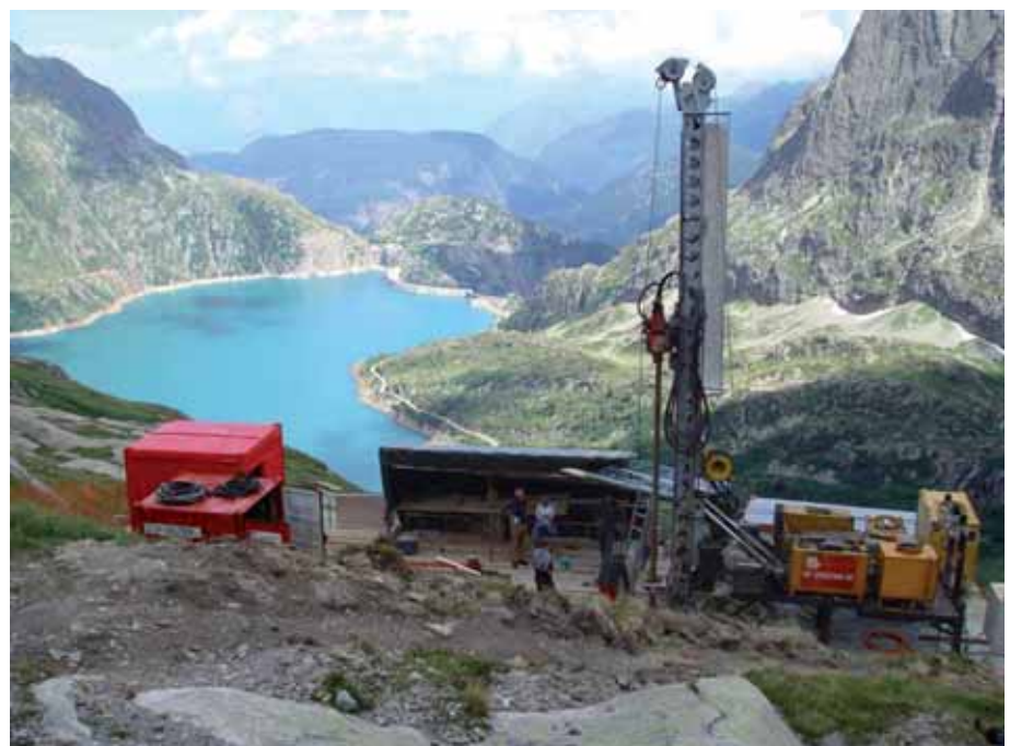
Bild 3. Bohrinstitutionen Emosson – Tiefensondierbohrung im Bereich der Vertikalschächte – im Hintergrund der Stausee Emosson.
